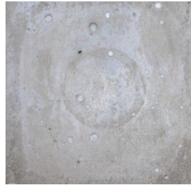
写真5 試験器貼付箇所 (白化) (融雪剤とけい酸塩系表面含浸材塗布試験体)
