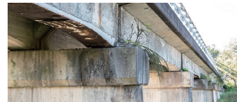
劣化した橋梁
