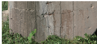
劣化した橋脚
