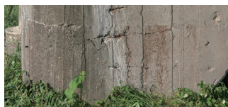
劣化した橋脚
