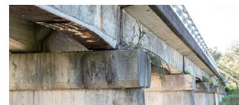
劣化した橋梁
