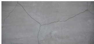
初期ひび割れ
